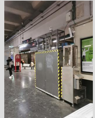
Station de mesures en gare RER C Avenue Foch
