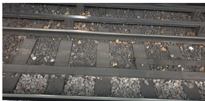
Figure 27 – Présence de ballast sur les rails de la station de métro
